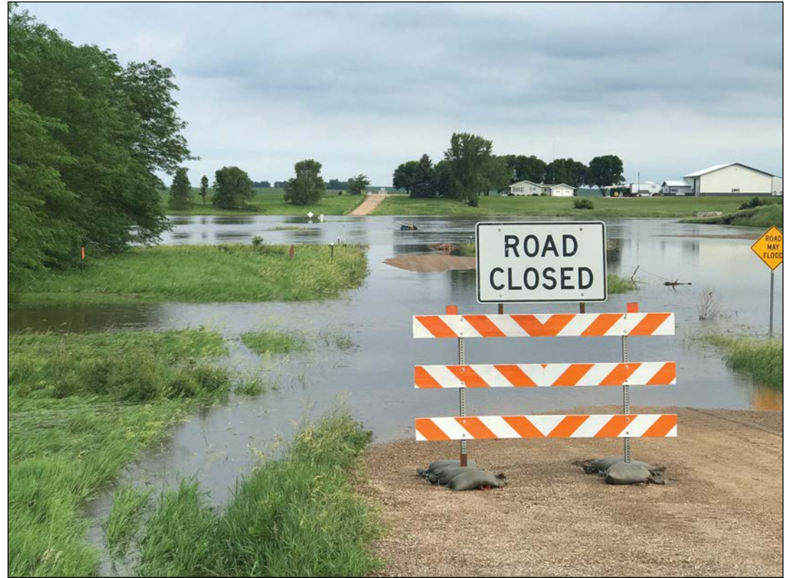
Lori Sorenson photo/0628 flood
